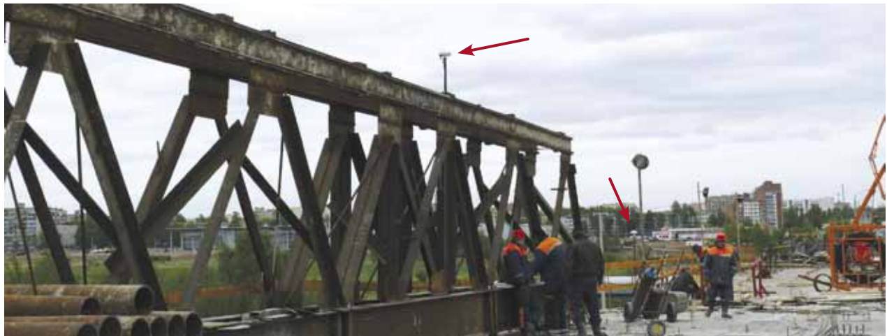
Рис. 5. Размещение антенн приемников сигналов систем ГЛОНАСС и Navstar на конструкциях моста через реку Днепр в г. Могилеве
