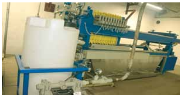
Рис. 52. Установка для изготовления волокна «Арселон»
