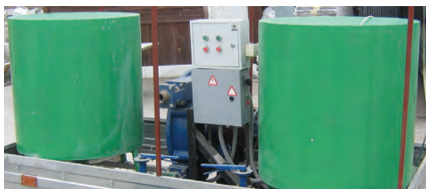
Рис. 4. Оборудование из состава КМО
